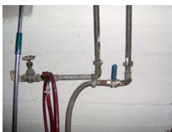
Defekt spulehane og forkert monteret Ventil på koldt vand.
