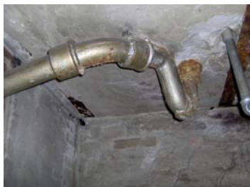
Afløb fra stueetage med synlige tæringer
